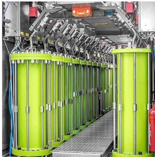
Abbildung 3: Innenraum des Schwungrad-Energiespeichers der Firma STORNETIC
