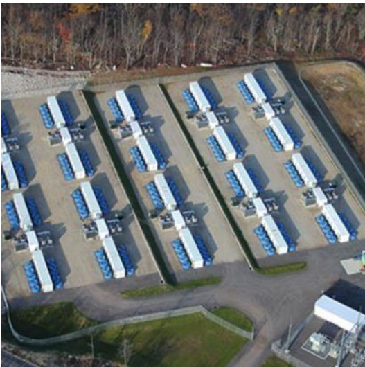
Abbildung 4: 20MW Speicher zur Frequenzregulierung in Pennsylvania, USA (Beacon Power)
