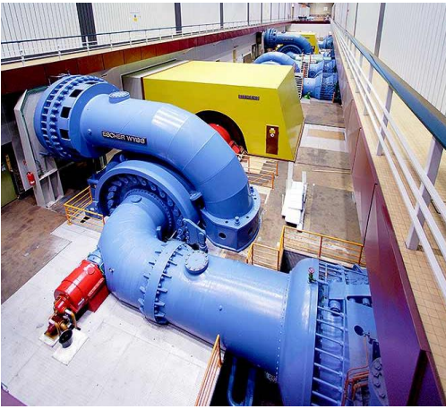
Abbildung 1 Maschinensatz im Kraftwerk Wehr 1
