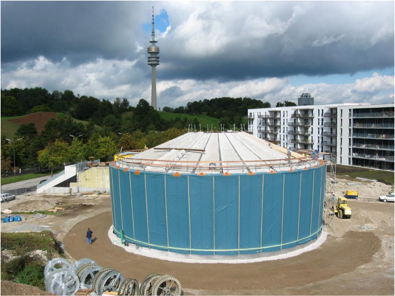
Abbildung 3: Vom ZAE Bayern entwickelter (BMU gefördertes Projekt 0329607G) saisonaler Nahwärmespeicher (6000 m 3 ). Ladung durch Solarwärme mit 48% Deckungsgrad (3000 m 2 Kollektoren).
