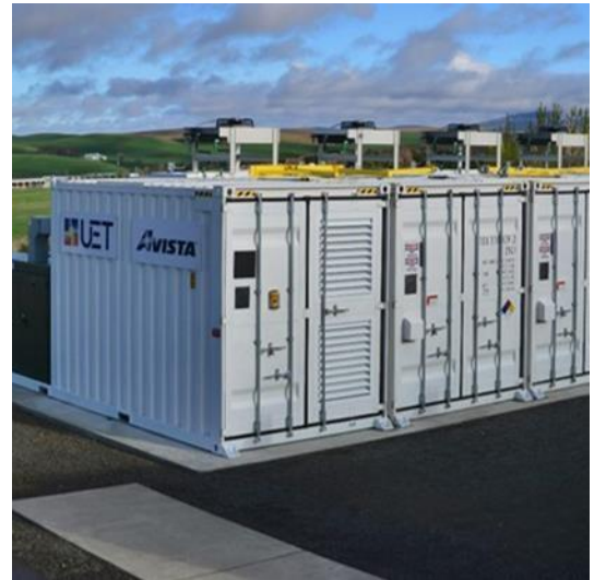
Abbildung 3: Größte Vanadium Redox Flow Batterie außerhalb Asiens (1MW/4MWh), von UniEnergy Technologies (Bildquelle: UniEnergy Technologies)
